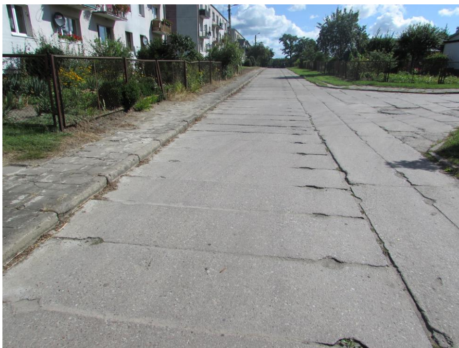
Zdjęcia 19 Drogi i chodniki wymagające remontu
