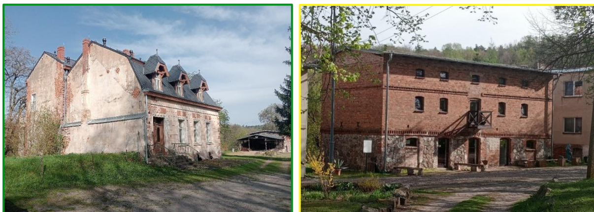
Rycina 10. Przykłady przestrzeni wymagających poprawy stanu technicznego na obszarze rewitalizacji
