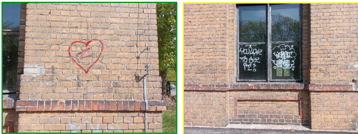
Rycina 7. Przykłady aktów wandalizmu na obszarze rewitalizacji: graffiti na budynkach
