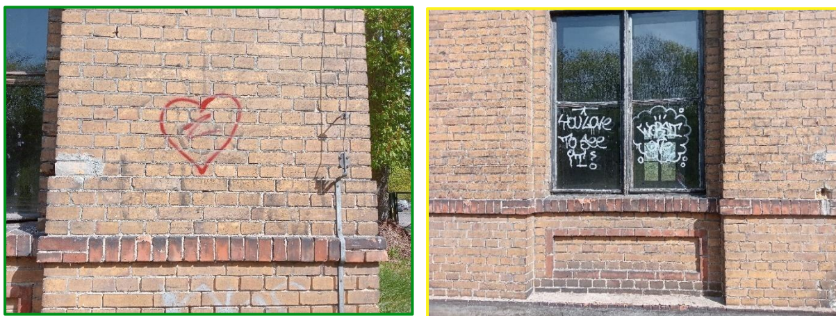
Rycina 7. Przykłady aktów wandalizmu na obszarze rewitalizacji: graffiti na budynkach
